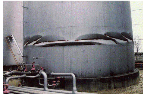
(d) Diamond pattern buckling of tank wall
