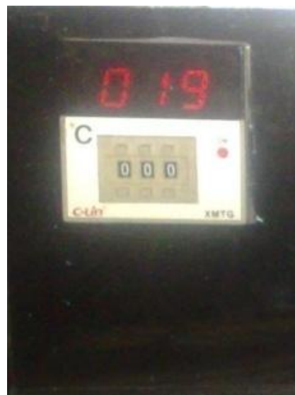
Рис. 2.20. Включенный Термоконтроллер печи.
